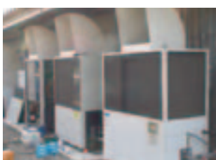
設置状況の確認
